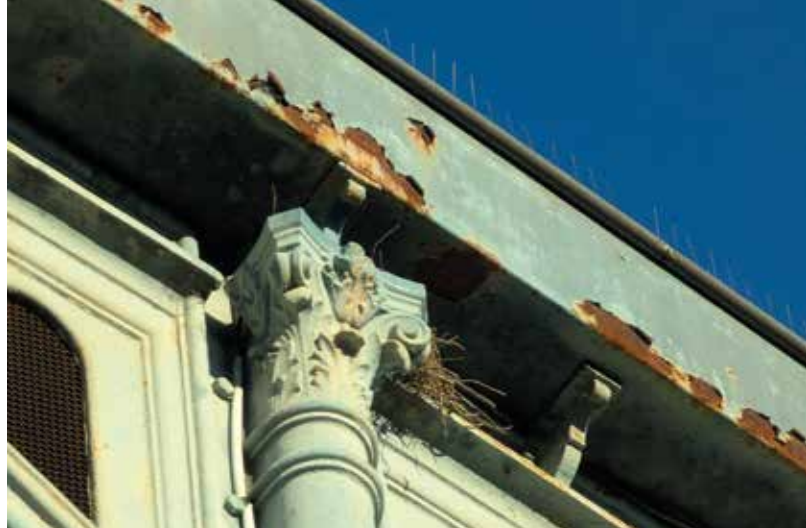
▲ Corrosion avérée sur l'ensemble de la structure métallique
